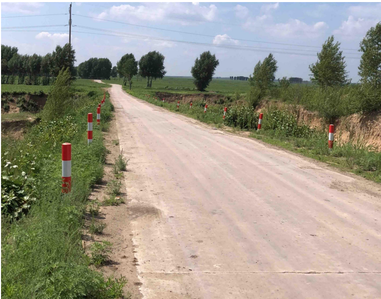
典型高填方路基隐患照片
