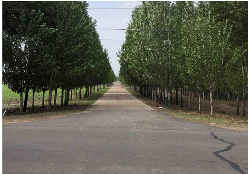
典型交叉路口隐患照片
