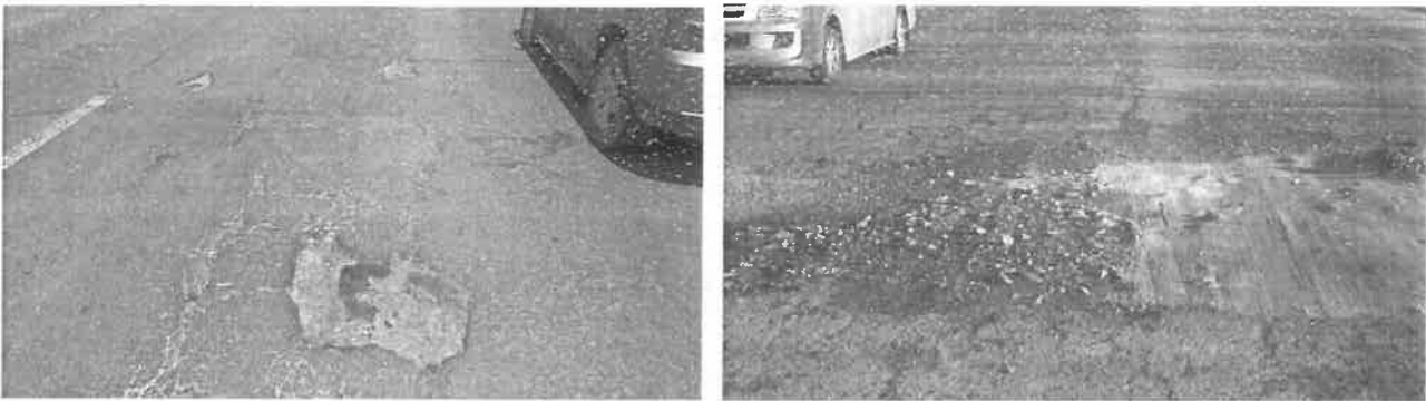
路面损坏类型图示分为坑槽：0.826 平方米
